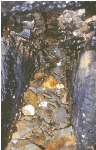
Photo 1 : Eboulis de la maçonnerie d'obturation du puits 10, fin de la partie aujourd'hui pénétrable du tunnel (J. Provost).
